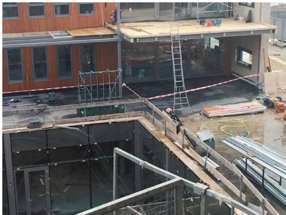
De zwaarste belasting van een gebruiks dak is tijdens de uitvoering.
